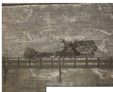
損傷(表面劣化)
