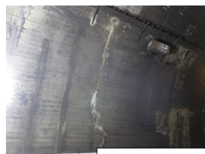
損傷(ひび割れ)
